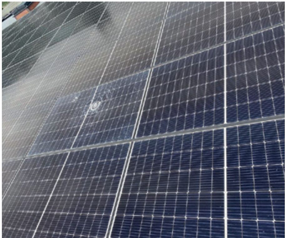
Wegen Hagelschlag: Glasbruch eines Moduls auf der Eihalle.
