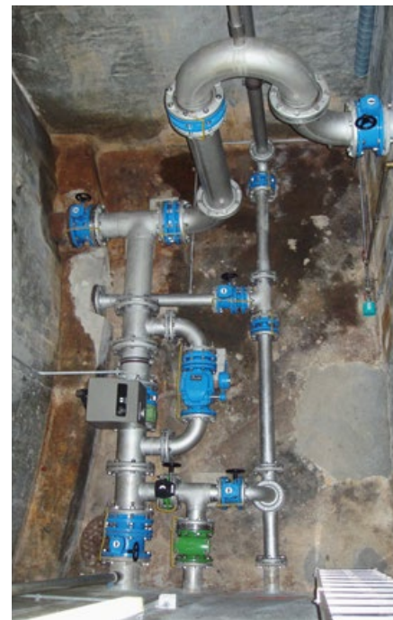
Rohrkeller im Reservoir Geissbühl
