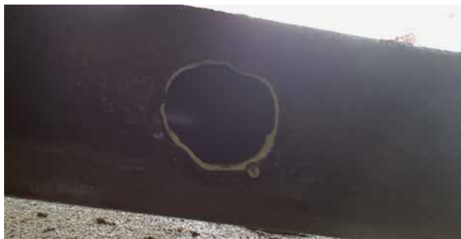
Auf der Unterseite des Rohres klafft ein faustgrosses Loch (Leck vom 1. August 2017)
