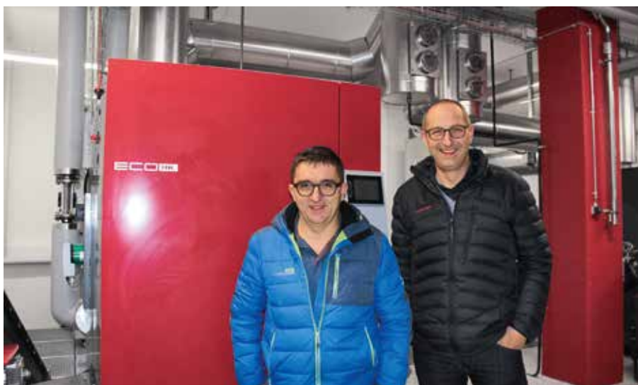
Markus Schmid und Markus Heitzmann, Inhaber der gleichnamigen Firmen, initiierten den Wärmeverbund Schachen und heizen künftig 276 Wohneinheiten.
