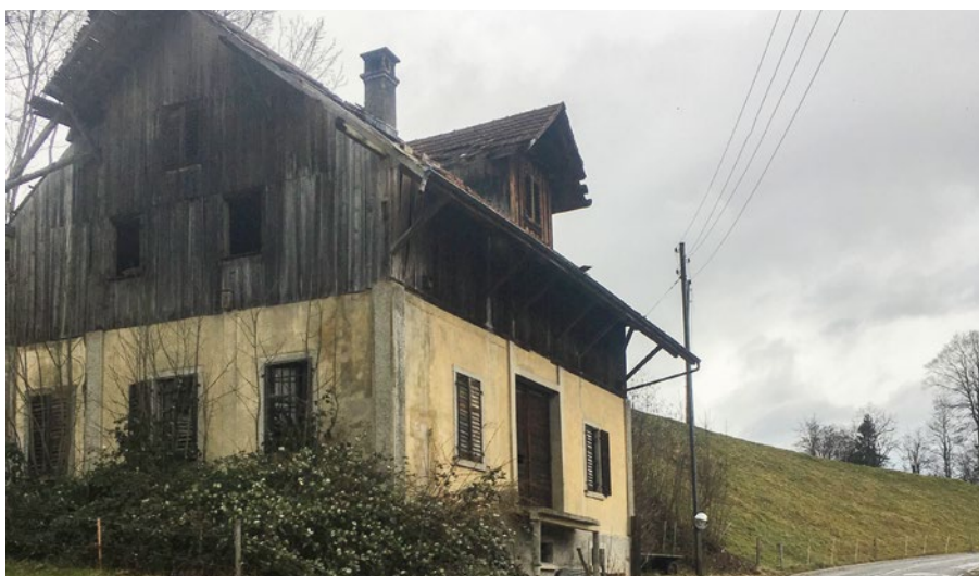
Die starken Winde deckten das Haus ab
