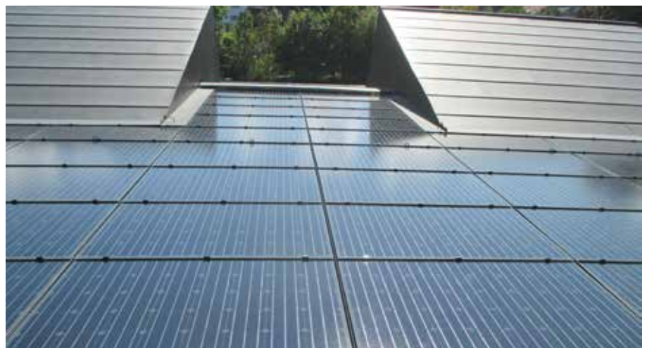
Die Jury beurteilte die Installation auf dem Dach als eine sorgfältig gestaltete PV-Anlage
